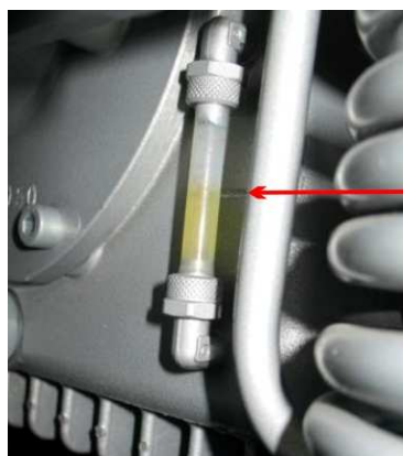
Prawidłowy poziom oleju
